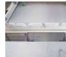
※床板のエキスパンションの外れ
